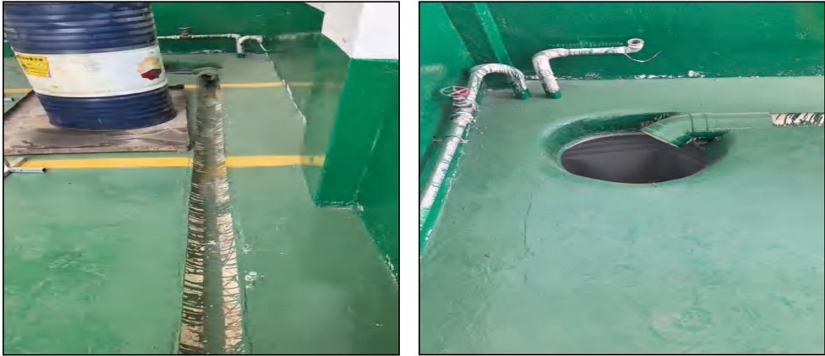
危废暂存间内部导流槽及事故池
