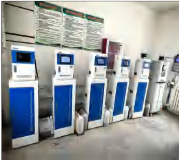
总排口在线监测设备
