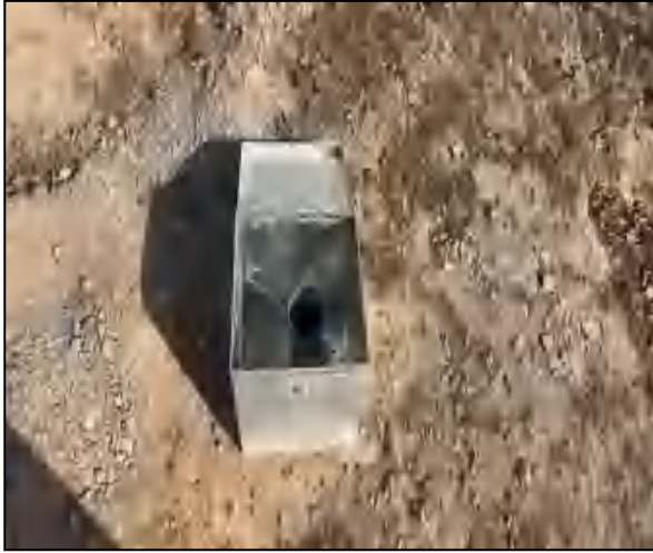
厂区中心地下水监测井
